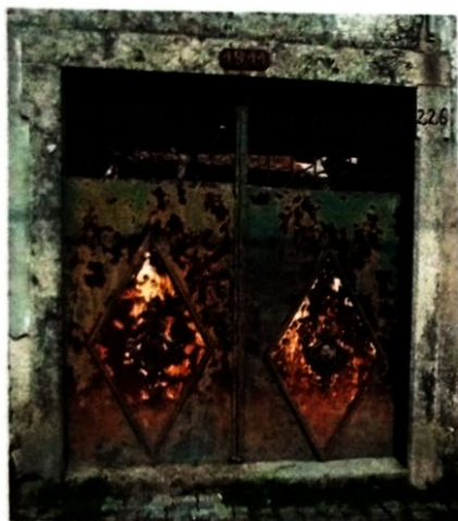
Fig. 39 – Portão de ferro com ferrugem.
